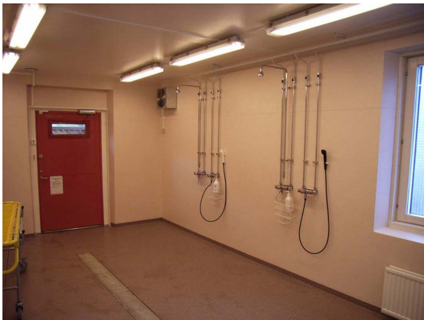
Exempel på fast saneringsanläggning, Vrinnevisjukhuset i Norrköping
